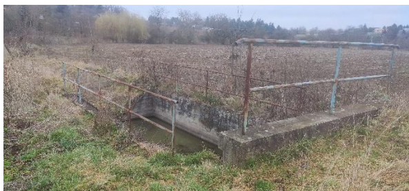
Stav před opravou
